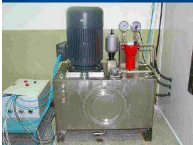
挤压试验台液压系统
