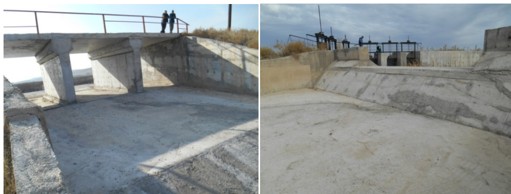
Рис. 7. Аварийный водосброс с широким порогом построенный после реконструкции.
