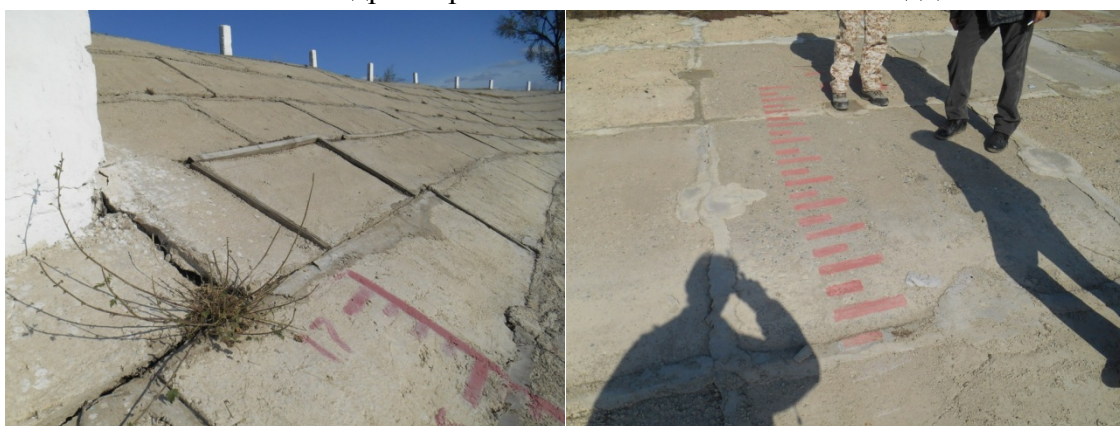
Рис.11. Гидрометрические рейки на откосах плотин.
