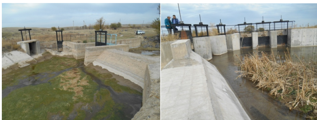
Рис.5. Малые гидроузлы. Верхний бьеф. Особенность малых гидроузлов это простота управления, частое заиливание подводящего русла.
