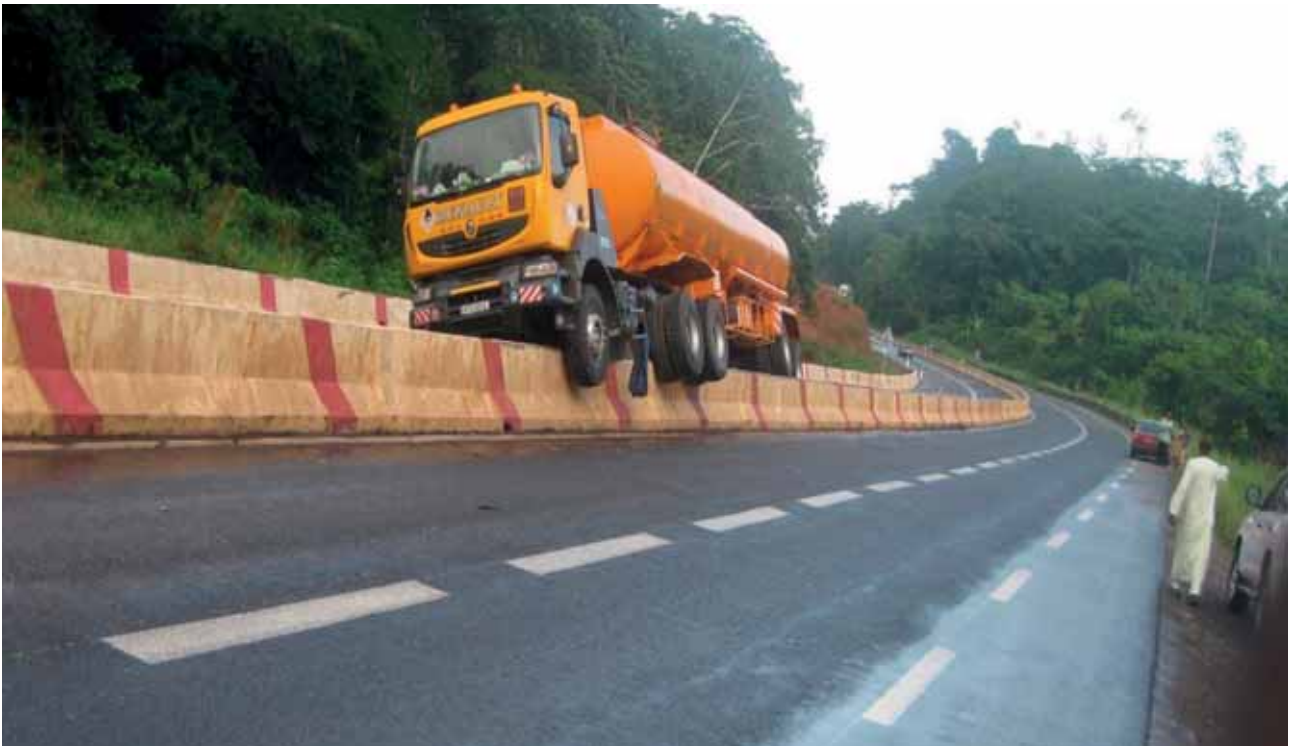
Photo 1. Réaménagement (dédoublage de la voie) amorcé avec l'appui de la Banque africaine de développement et de l'Union européenne sur la route nationale 3 de l'axe routier Douala-Yaoundé, à l'issue de l'inspection routière réalisée.
