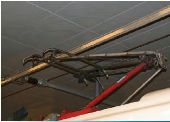
Figure 3.13 - Pantograph on an overhead conductor rail at the Berlin main station S. Terfloth (User: Sese Ingolstadt - Eigenes Werk, Deckenstromschiene mit Stromabnehmer in Berlin Hauptbahnhof)
