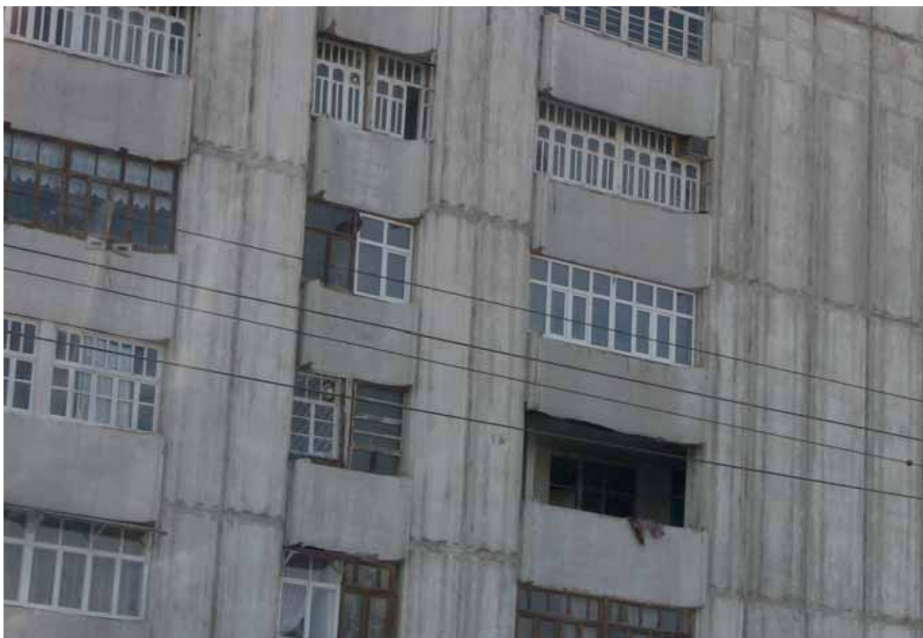
Фотография 4. Многоквартирный дом, требующий ремонта
