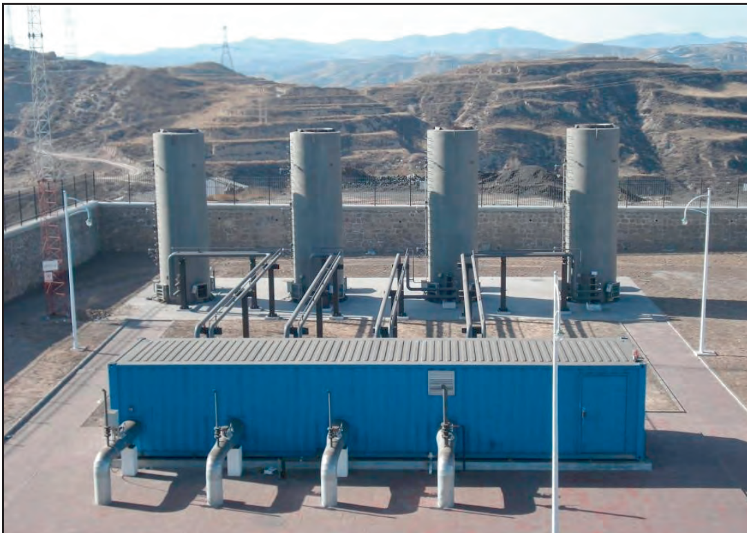
Figura 9.7 Sistema de antorchas en la mina T
