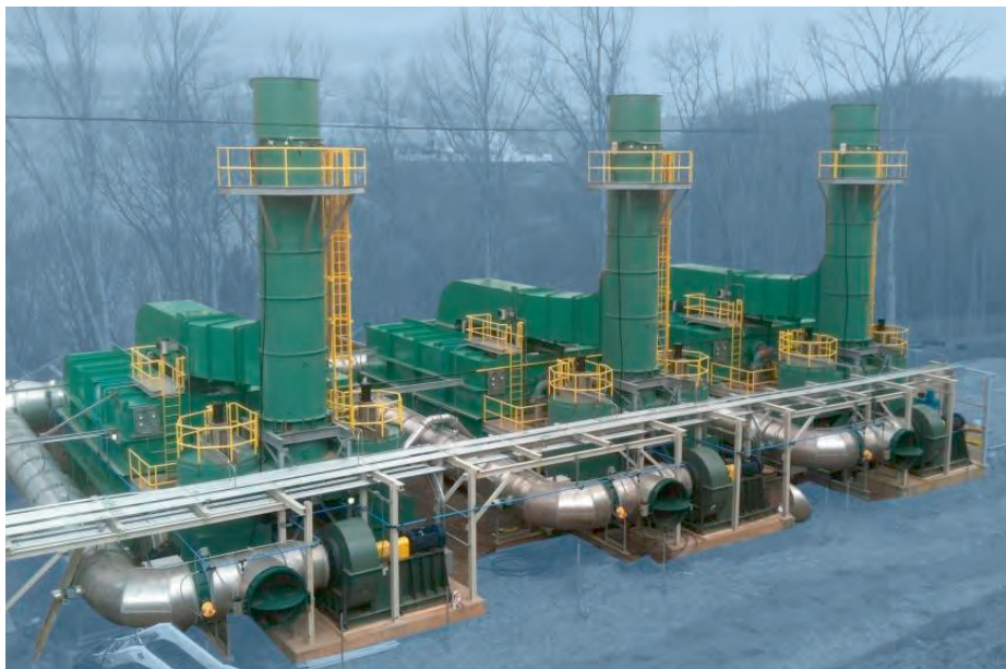
Figura 6.5 Instalación de procesamiento de VAM (3 OTR) de Dürr en la mina McElroy (Estados Unidos)
