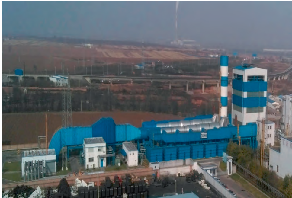
Figura 6.6 Instalación de procesamiento de VAM de Dürr Systems en la mina de Gaohe (China)
