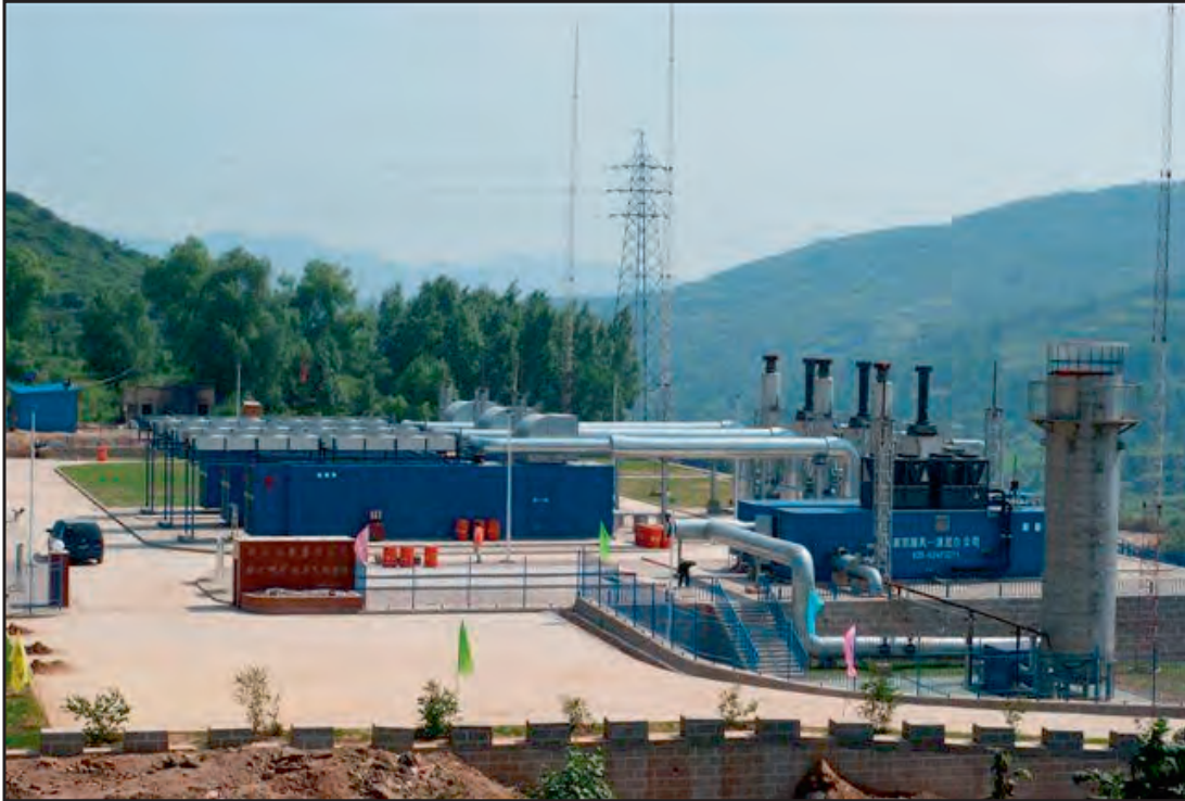
Figura 9.6 Fase 1 de la central de cogeneración con MMC en la mina D
