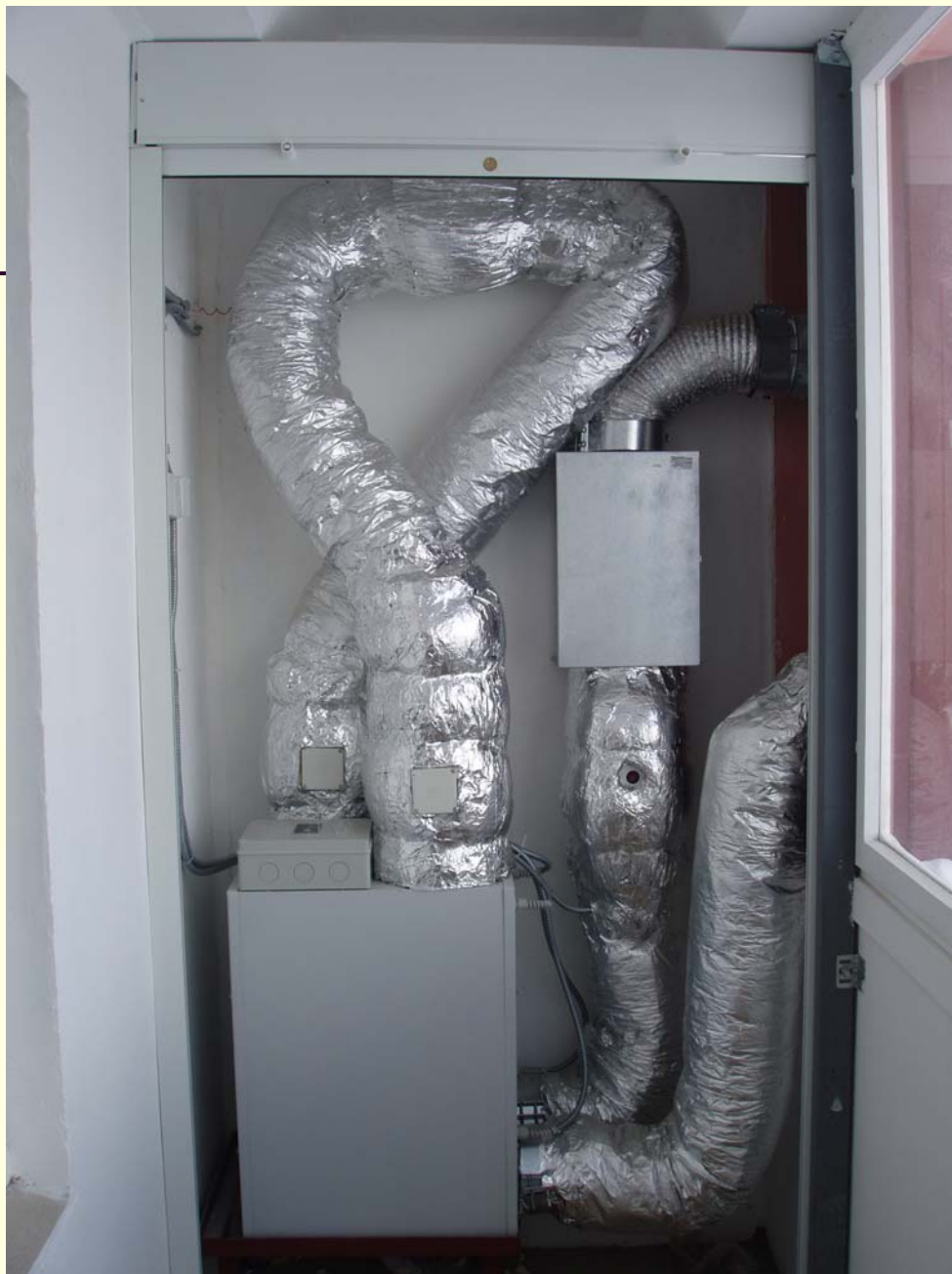
Рис. 9. Рекуператор тепла и сопутствующее оборудование
