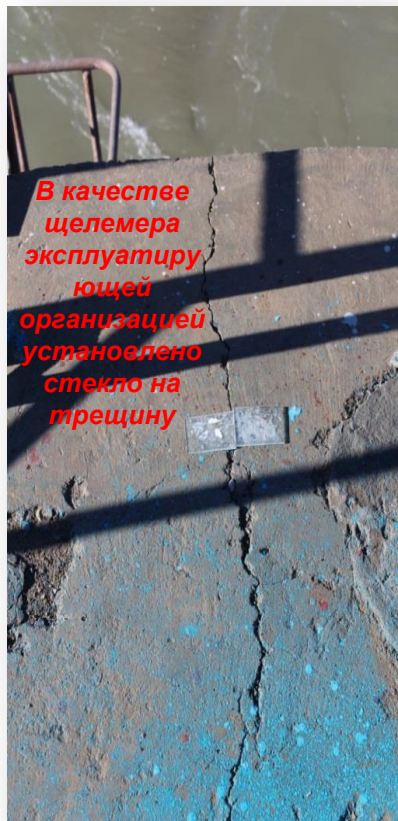
Рисунок - 4. Трещины на гребне водосбросной плотины между четвертым и пятым бычками в сторону верхнего бьефа
