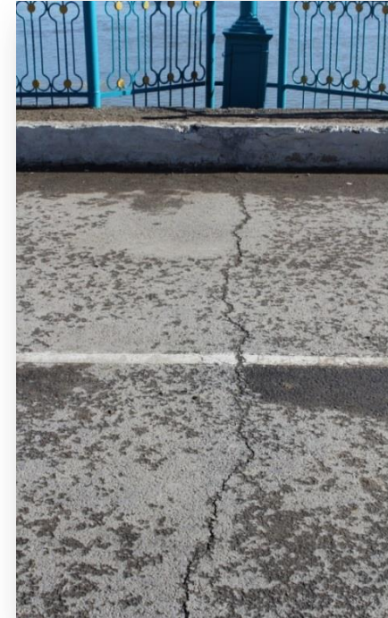
Рисунок -3 Трещины на гребне водосбросной плотины между четвертым и пятым бычками в сторону нижнего бьефа
