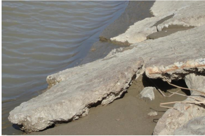
Рисунок -1 Деформация монолитной ж.-б. облицовки в придонной части и выклинивание фильтрационных вод.
