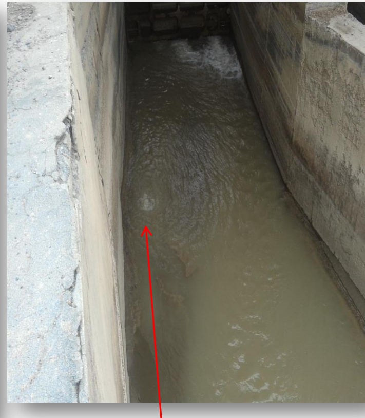
Рисунок 6 Выкливание воды под основания Левобережного шлюза регулятора
