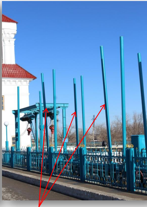
Рисунок – 5 Перекосы винтовых устройств подъемных механизмов затворов Правобережного шлюза-регулятора
