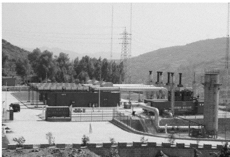
图 9-6 在 D 煤矿的煤矿瓦斯电厂第一期
