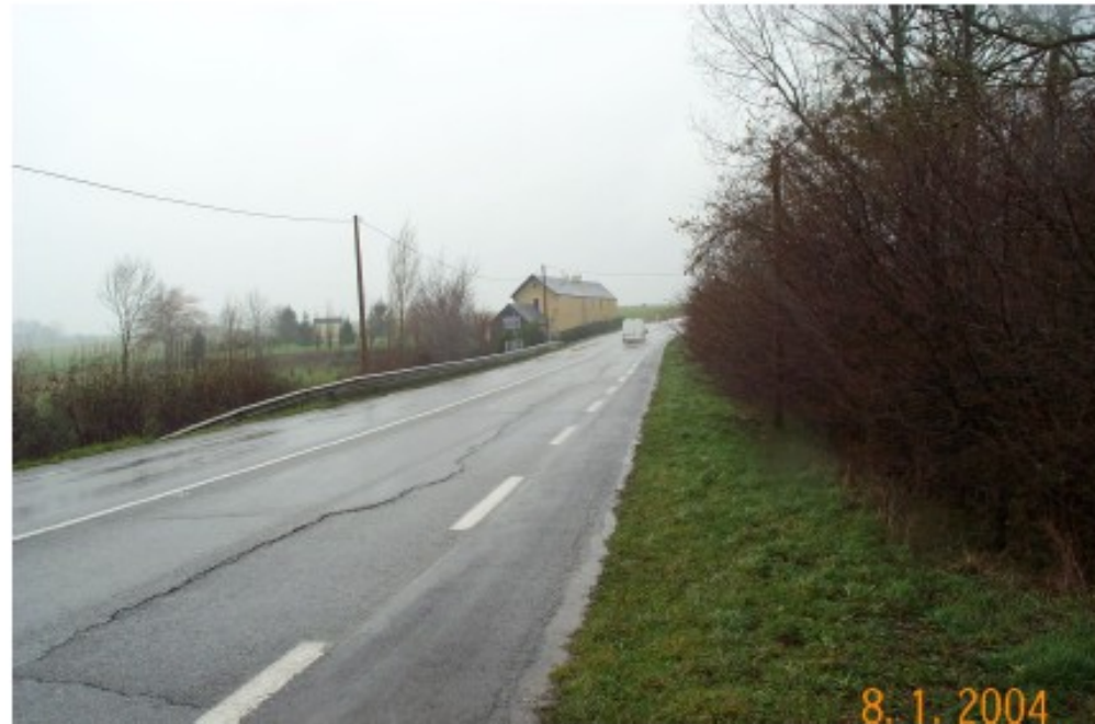
Figure 18 : Photographie d'un remblai situé sur la RN158 à Macé (61) dont les désordres (fissurations et tassements) se sont aggravés suite à l'été 2003. Source : Laurent Dubois.
